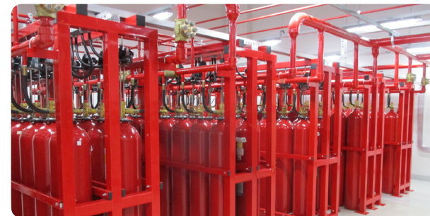
■ 自動氣體滅火系統設置
